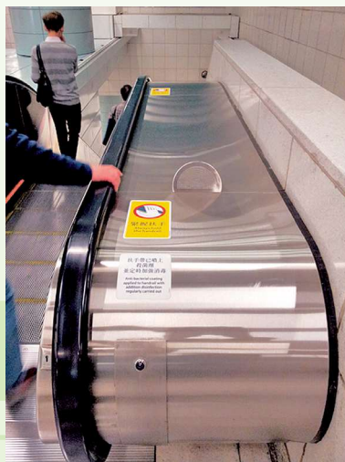
扶手電梯附設發聲器 Audible device at escalators
